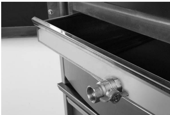
Vanne de purge ouverte. (Poignée à l'horizontale)
